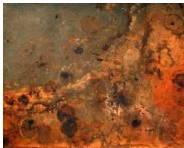
Obr.: koroze http://nd.blog.cz/
